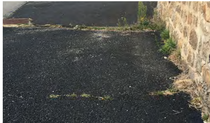
Béton noir plus ou moins dégradé ...
